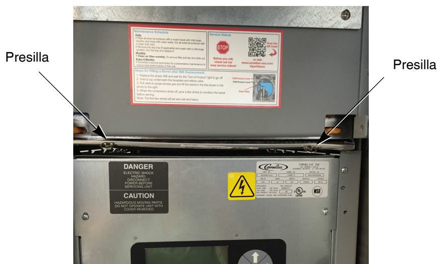
Figura 37. Ubicación Del Filtro De Aire
